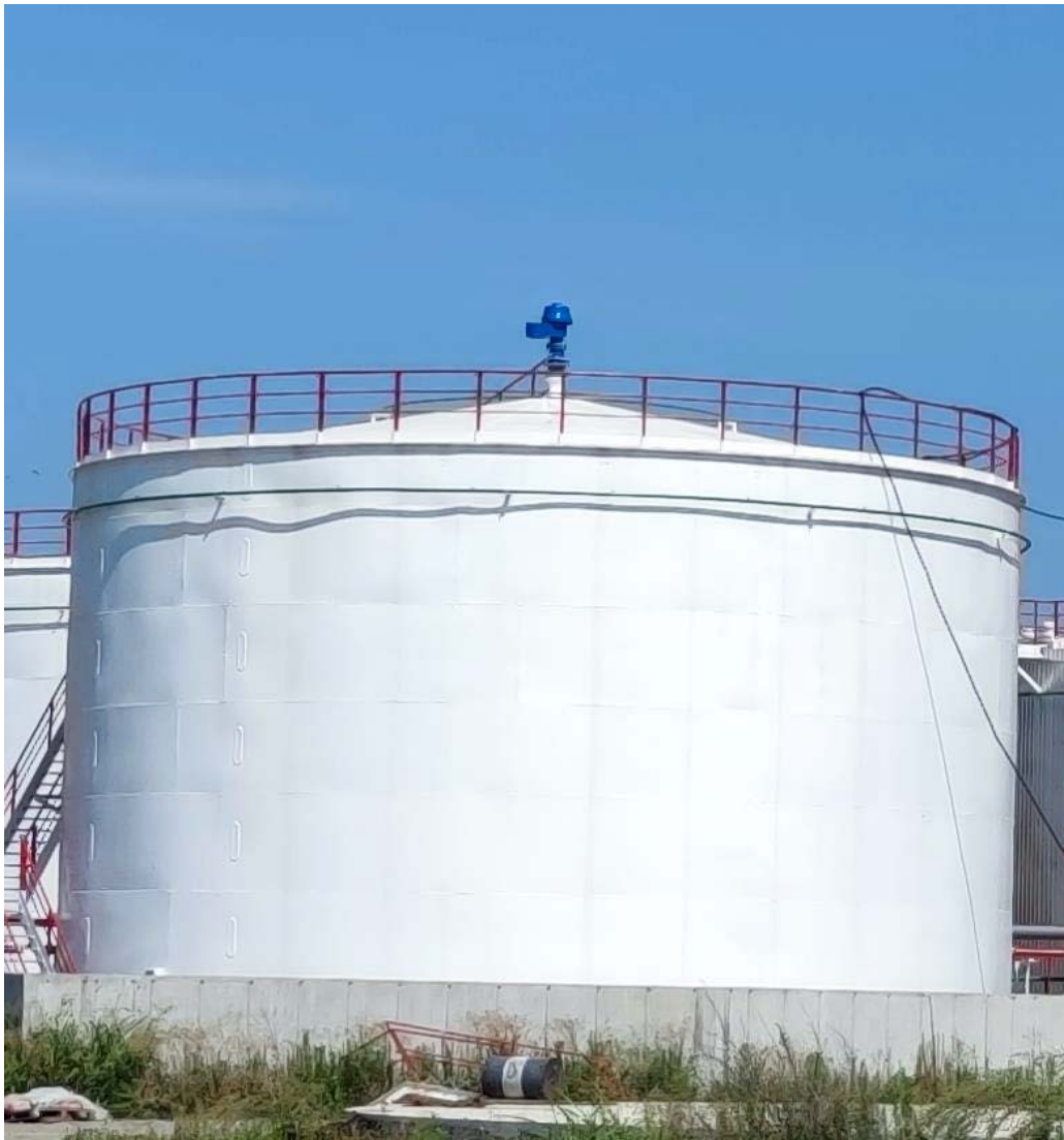
Слика 3. Надземни складишни резервоар – Р4 запремине 2000м 3
