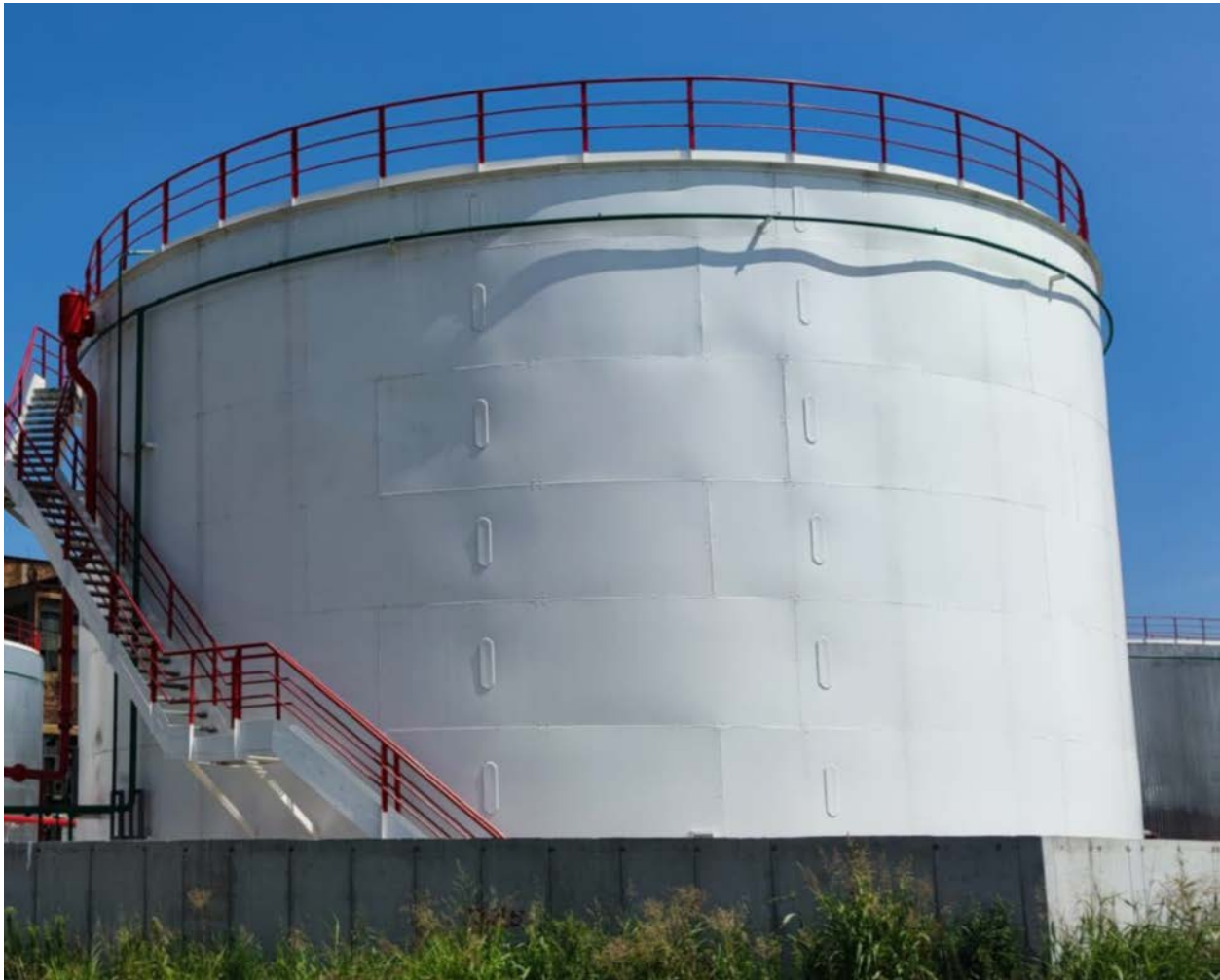
Слика 4. Надземни складишни резервоар – Р5 запремине 2000м 3
