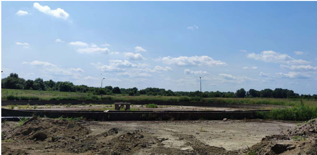
Слика 8. Базен за противпожарну воду
